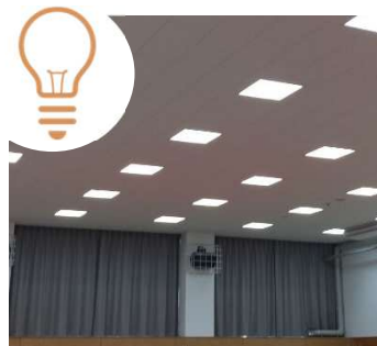
公共施設の 照明LED化
