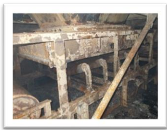
No.2 破砕物搬送コンベヤ
