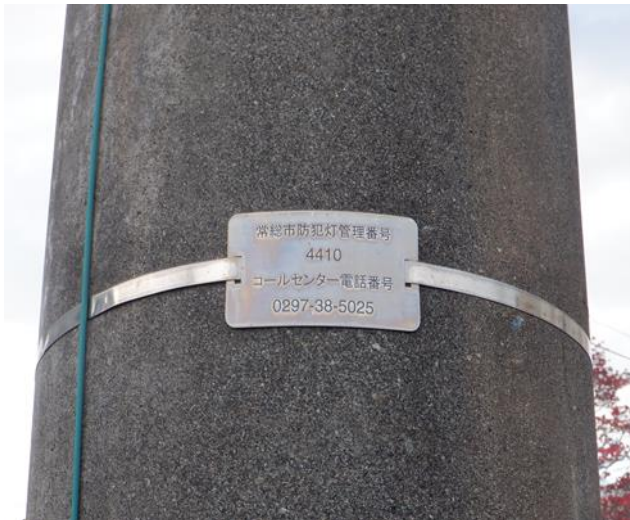
常総市防犯灯 管理プレートの写真
