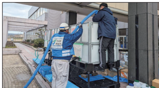
▲避難所に設置されたタンクに給水する職員
