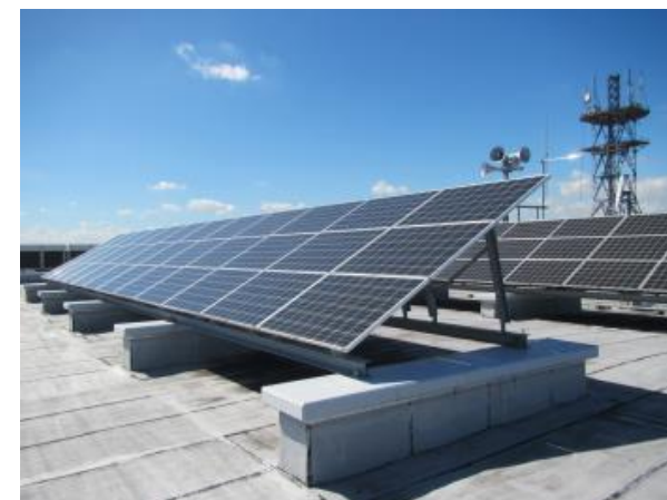
屋上を活用した太陽光モジュール
