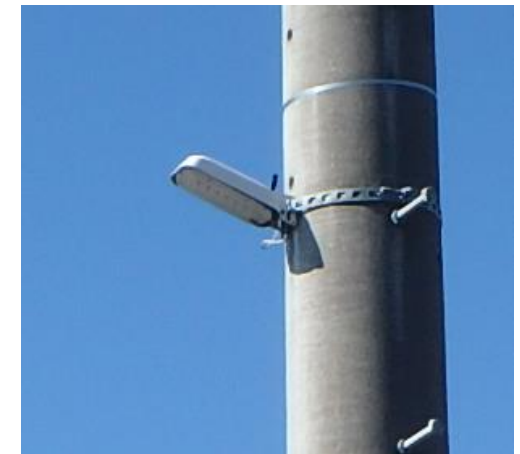
市で設置しているLED防犯灯
