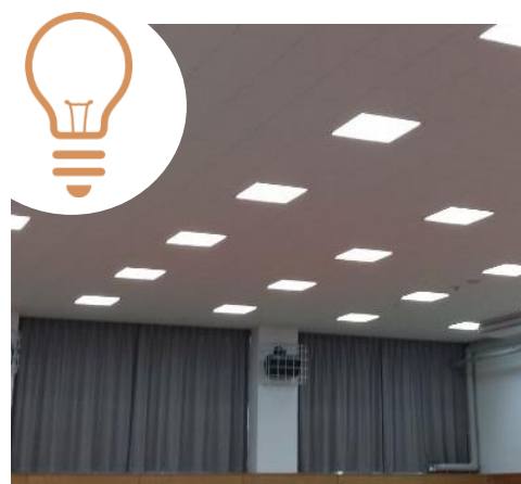
公共施設の照明LED化
