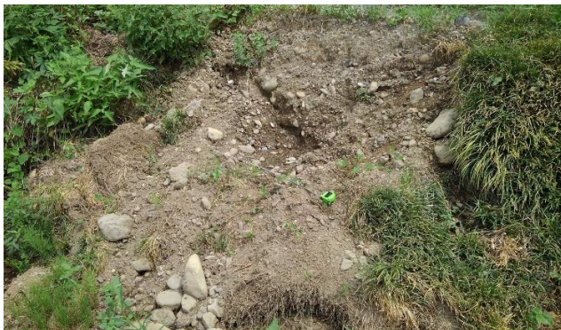
農道の法面の掘り返し
