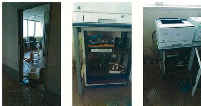
図 2.4 浸水した配車システムの設備
