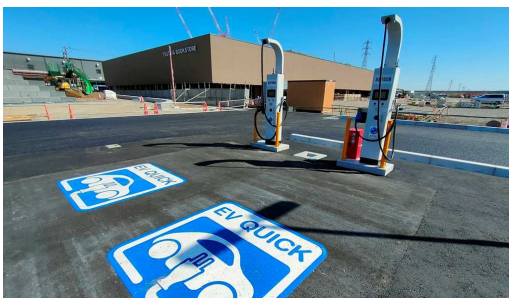
道の駅常総に設置された電気自動車用急速充電器
