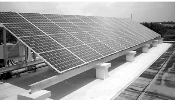
太陽光発電システム
