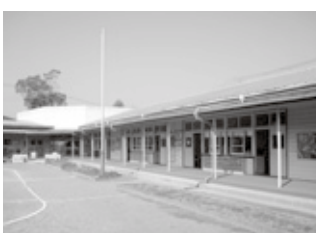
老朽化が進む園舎
