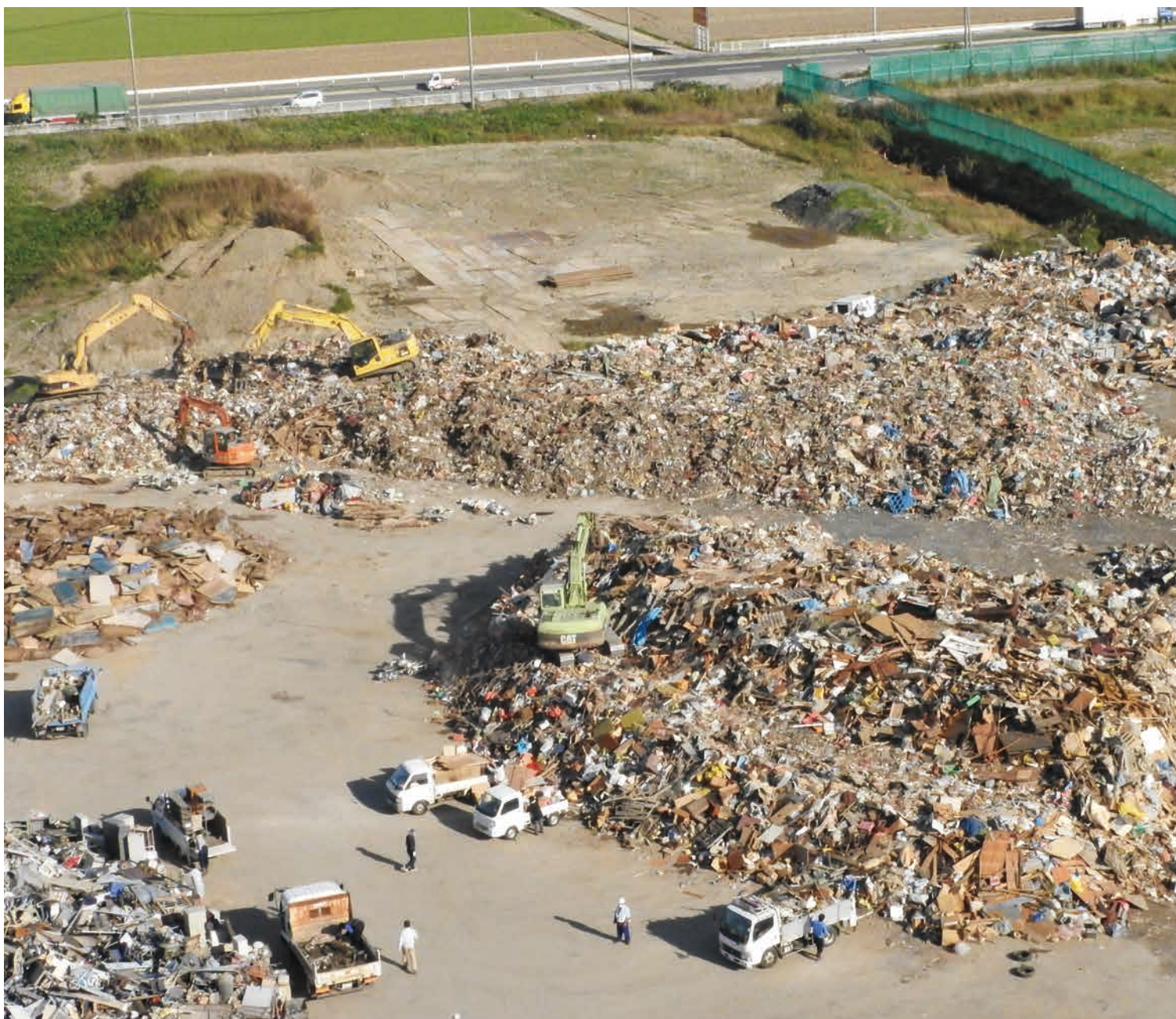
決壊から約1か月後の災害ごみ仮置場。連日運び込まれる災害ごみが積み上がる地域交流センター東側（10月14日、新石下）
