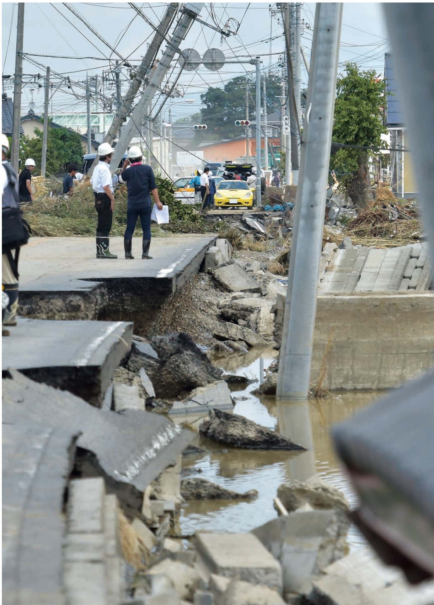
決壊現場からの濁流で削られた道路のアスファルト（9月12日、三坂町）
