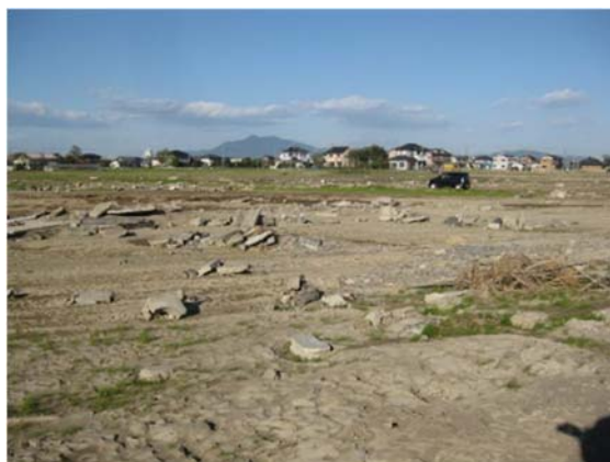
堤防決壊現場（上三坂地区）付近の農地
