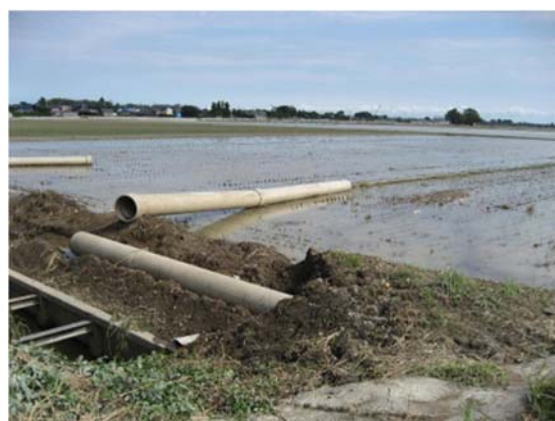
破損した送水管
