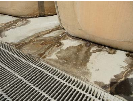
保管容器下部からの汚水の浸み出し
