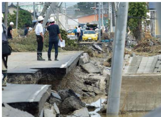
決壊現場付近 上三坂地区
