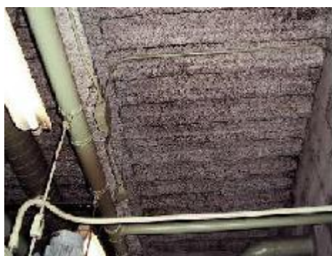
石綿含有吹付けロックウール
