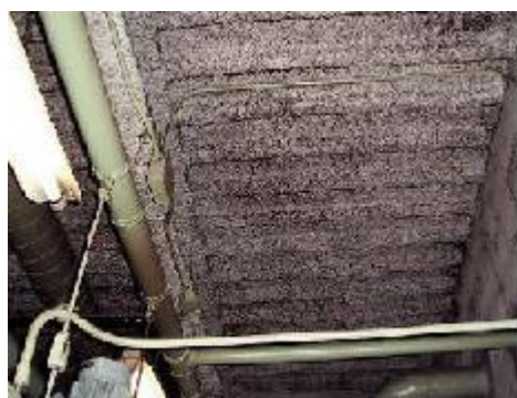
石綿含有吹付けロックウール
