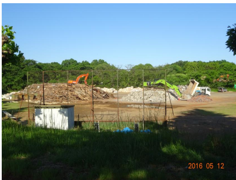
仮置場における建築廃材の分別（平成 27 年 9 月関東・東北豪雨災害）撮影：常総市
