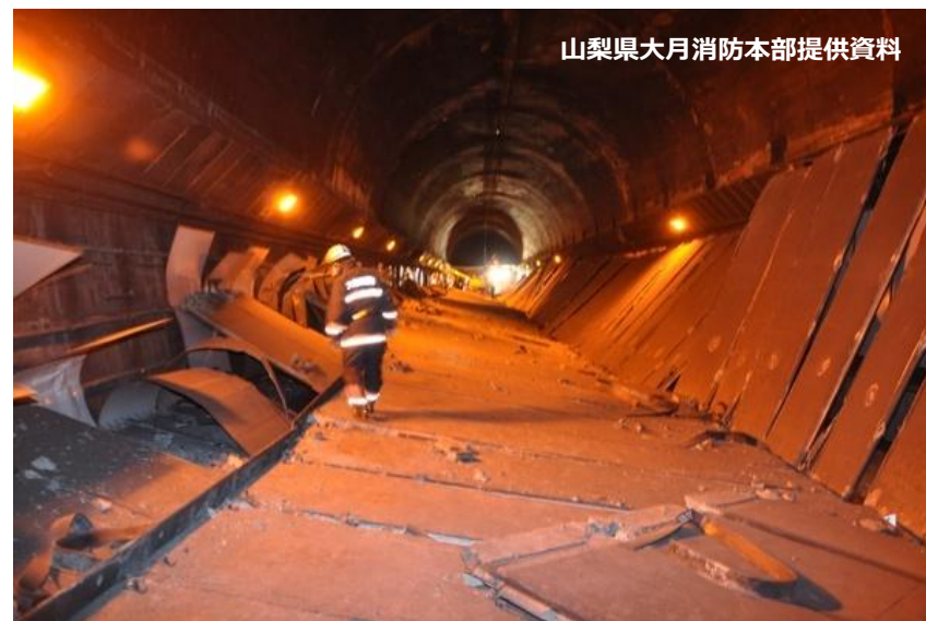
【写真】中央自動車道笹子トンネルの崩落現場
