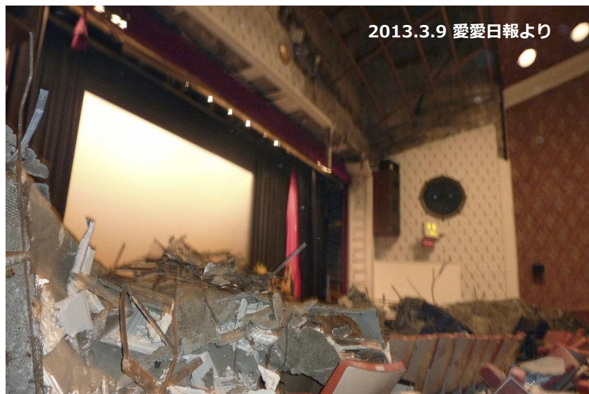
【写真】東日本大震災で天井が崩落した東京九段会館1階ホール
