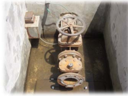
老朽化による撤去
