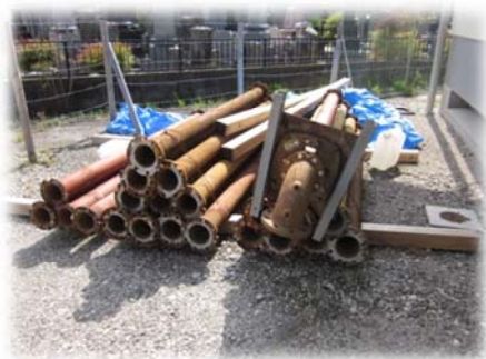
老朽化による撤去
