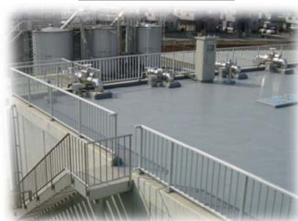
西部配水ポンプ
