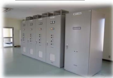
東部配水ポンプ制御盤
