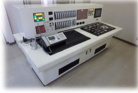
西部監視制御盤
