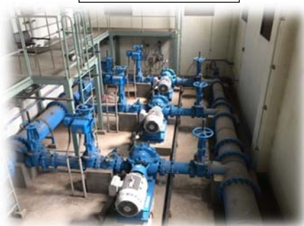
坂手配水ポンプ
