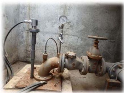
取水ポンプの老朽化
