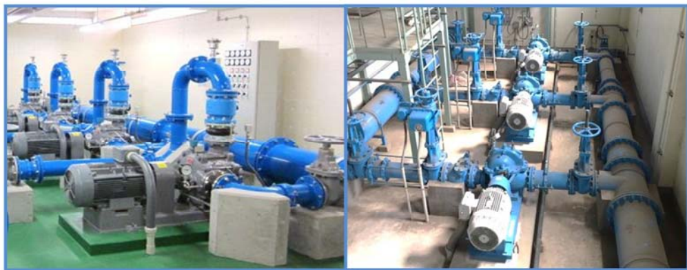
インバーター制御対応配水ポンプ
