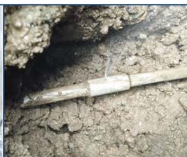
塩ビ管劣化・漏水
