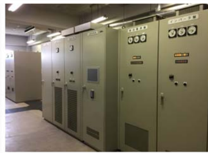
更新前の配水ポンプ盤
