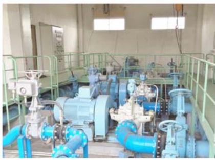
更新前の配水ポンプ
