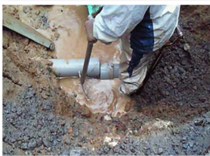
更新前の塩化ビニル管 (漏水)
