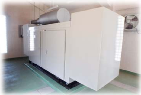
西部自家発電機
