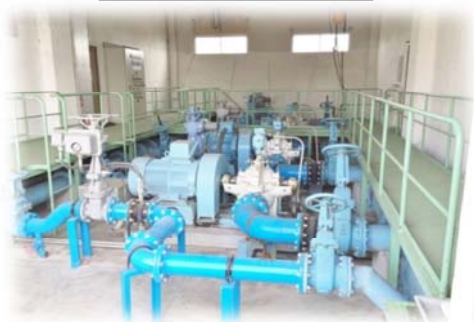
相野谷配水ポンプ
