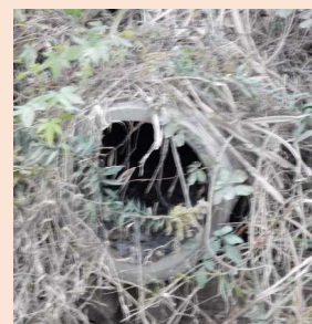
■ きぬ医師会病院駐車場付近の管
